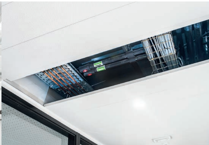
Bij zelfdragende panelen zijn uw technieken goed bereikbaar
